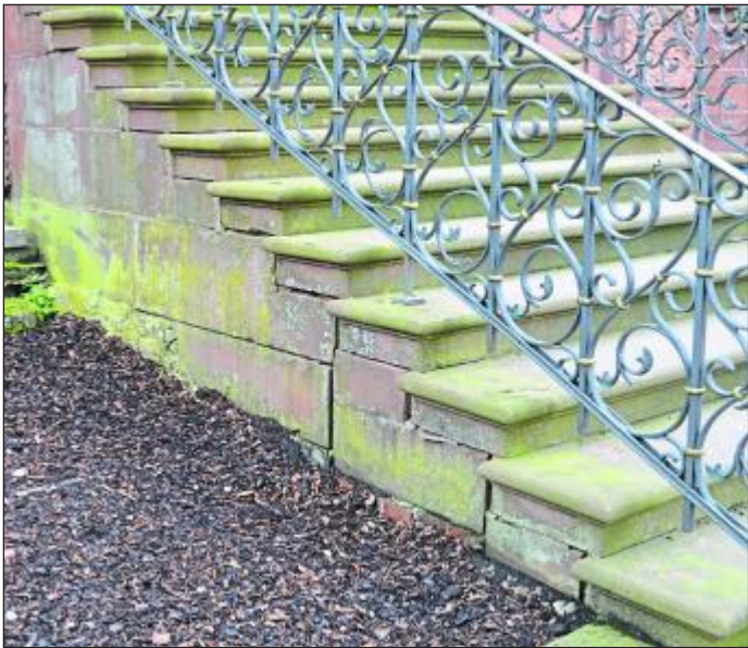
Die historischen Treppenaufgänge am Hünfelder Rathaus müssen komplett saniert werden. Ab Mitte Januar werden sie zunächst demon-
