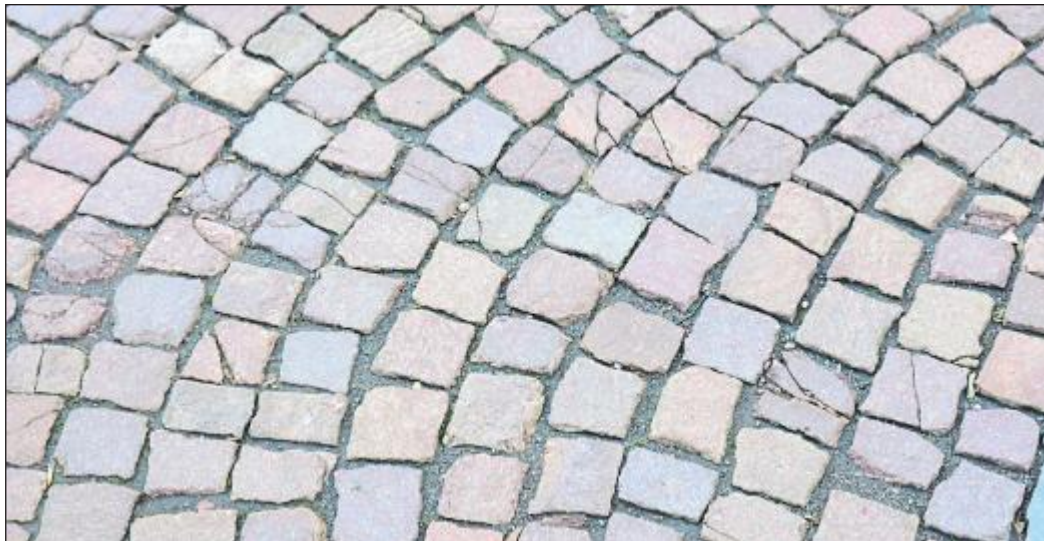
Das Porphyrpflaster in der Hünfelder Innenstadt weist zahlreiche Schäden auf.
