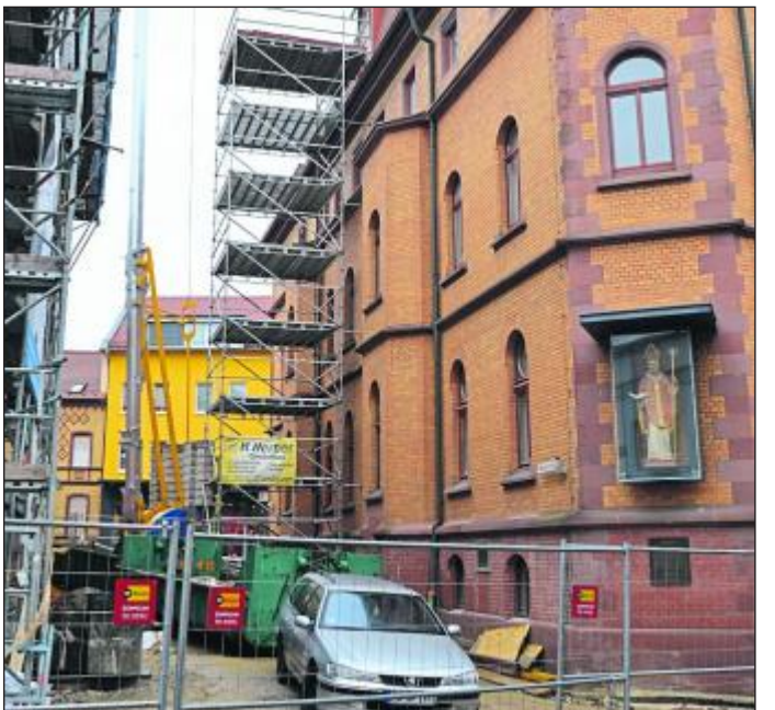
Brandschutzschleusen und eine Entrauchungsanlage sollen künftig im Treppenhaus des Rathauses den Brandschutz verbessern.
