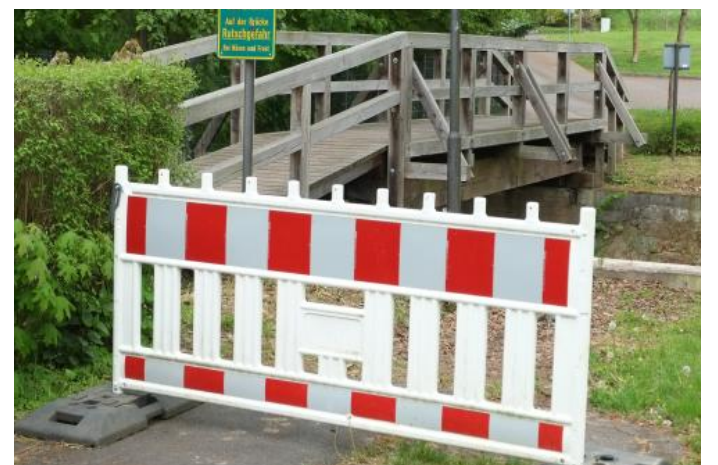
Zwei Brücken im Bürgerpark und am Haselsee mussten abgebaut werden, weil die Standsicherheit nicht mehr gewährleistet war.
