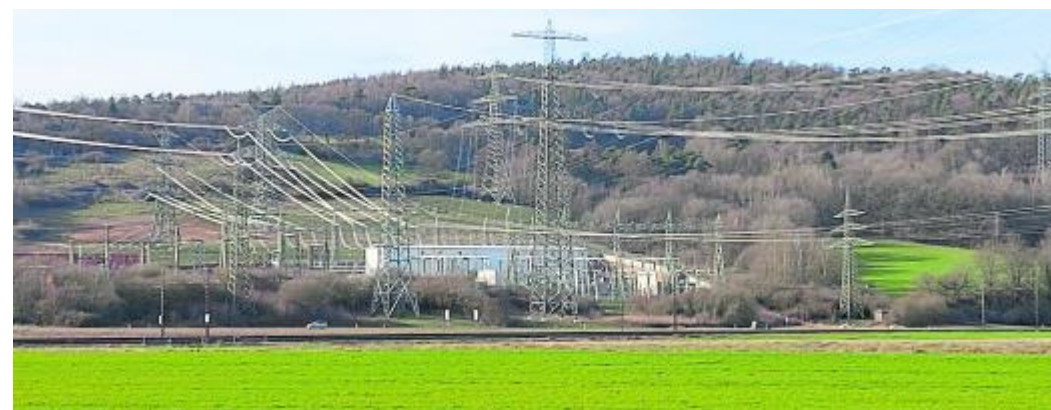
Das Umspannwerk im Ludwigsauer Ortsteil Mecklar (Kreis Hersfeld-Rotenburg) ist ein entscheidender Wegpunkt des Trassenverlaufs.
