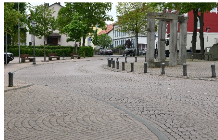
Die Klingelstraße soll erneuert werden. Vor allem vor der Stadthalle Kolpinghaus weist die Fahrbahn erhebliche Schäden auf.
