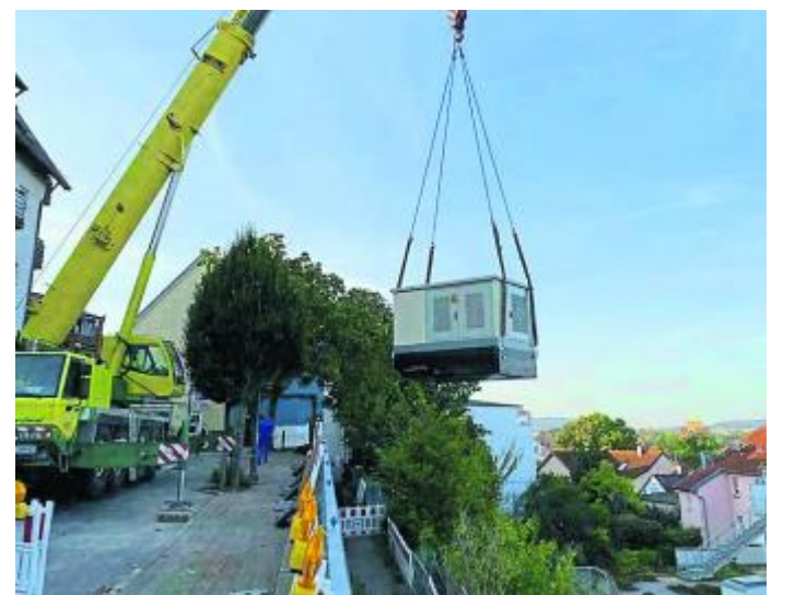
Zehn Tonnen wiegt die Transformatorstation, die am Hainmuerweg installiert wurde.
