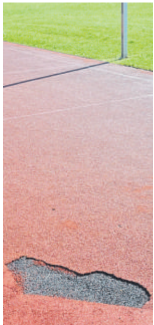
Mit roher Gewalt wurde der Belag beschädigt
